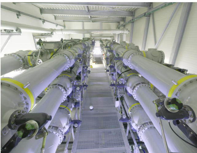
Aufgenommene Maschinen aus dem Innenbereich der Unterstation
